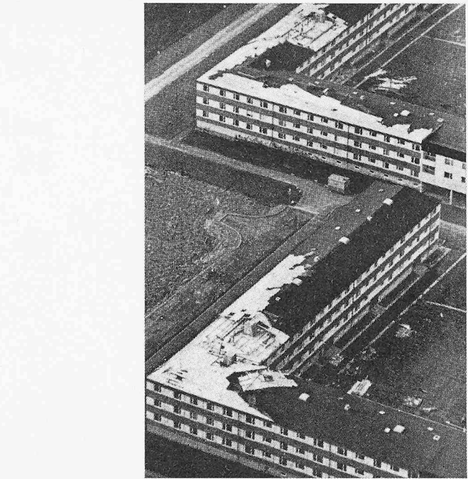
Bild 11. Typische Schäden, Anströmung über die linke Hausecke
