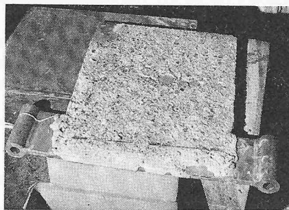
Bild 41. Nachträglich entfernte Verstärkungsplatte
