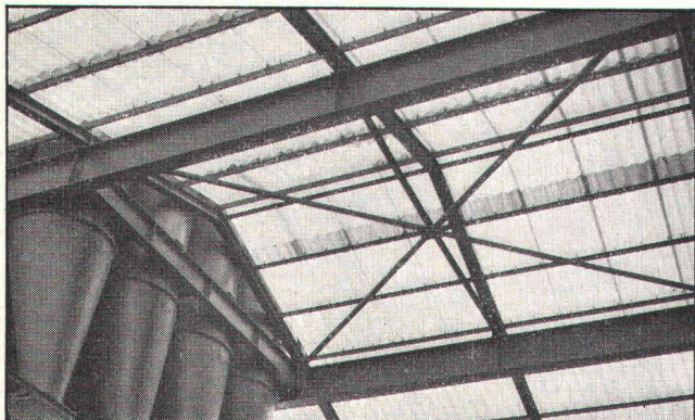
Neomat-Lichtdach auf einer Siloanlage
