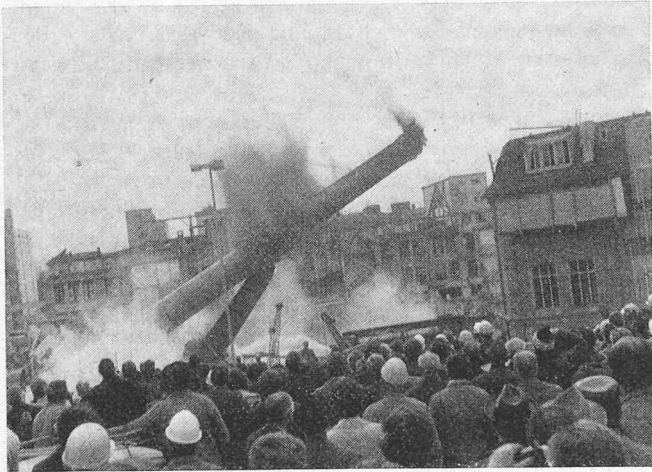
Die spektakuläre Sprengung des ersten in der Schweiz in Beton erbauten Fabrikamins am 17. März 1971
