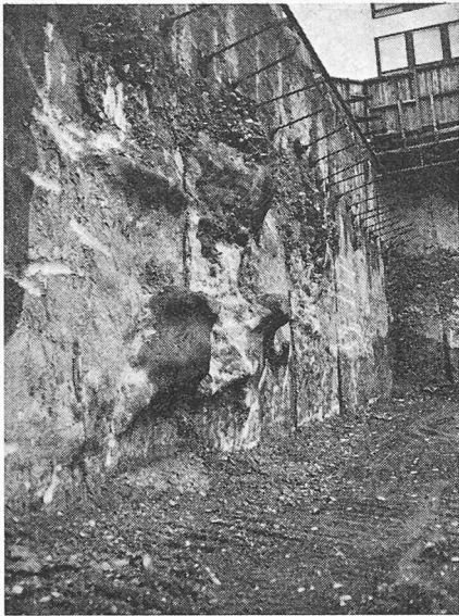
Bild 7. Überprofile, bedingt durch lokale Einstürze der Stützwand beim Schlitzaushub im Kies. Diese Überprofile wurden mit einem hydraulischen Krupp-Hammer abgespitzt
