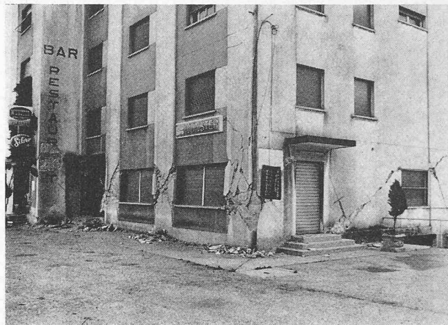
Bild 17. Fünfgeschossiges Hotelgebäude bei Venzone mit Wänden aus behauenen Natur- und Backsteinen. Beschädigung im Erdgeschoss durch typische X-Risse in den Fensterpfosten der Vorderfront und Diagonalriss auf der Stirnseite infolge inhomogenen Fundationsverhältnissen
