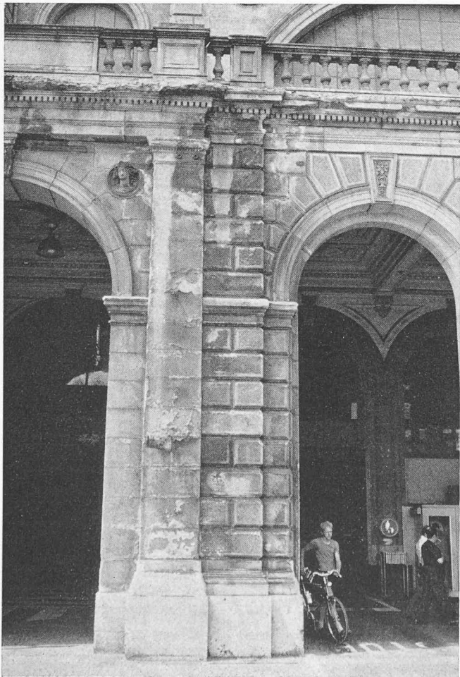
Bild 9. Restaurationsarbeiten am Hauptbahnhof Zürich. Abgesprengte Gurten, wegen durchgerosteten Abfallröhren durchnässter Pfeiler. Photo: Institut für Denkmalpflege, ETHZ
