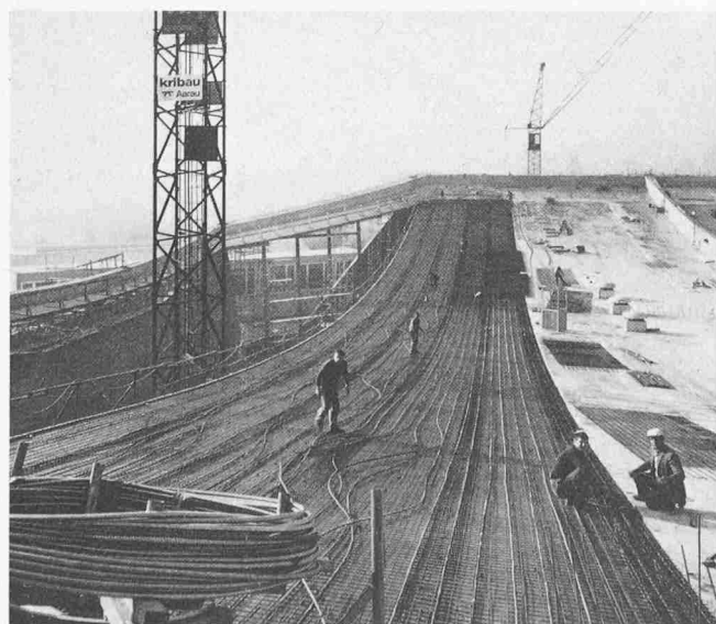
Bild 14. Armierung eines 10 m breiten Streifens der Hängeschale Reinforcement and prestressing steel for a 10 m wide strip of the suspended shell
