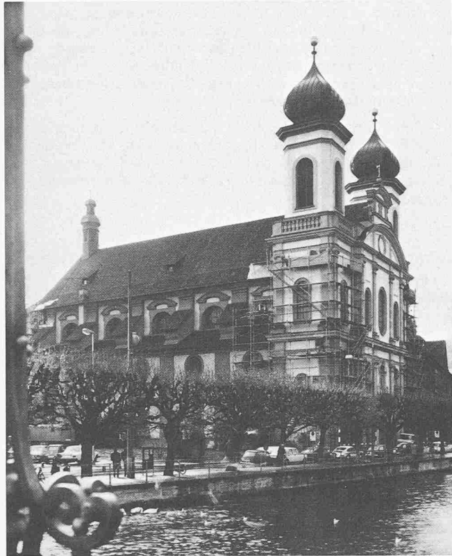
Fig. 1. Vue de l'église. L'échafaudage de la tour sert à la préparation des niches et à la mise en tension des câbles View of the church. The scaffolding is used to prepare the niches and to stress the cables
