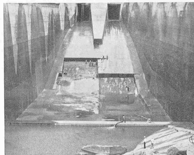
Bild 4. Nach 17 Stunden Probetrieb wurden 1976 erneut 2000 m 3 Beton weggetragen und weiter unten (vorne im Bild) abgelagert
