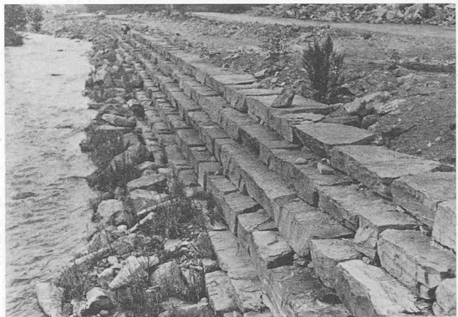
Bild 2. Aufwendige Trocken-Blockmauerung bei Rodi-Fiesso. Erschwerte Bepflanzungsmöglichkeiten durch Ausspülen des Feinmaterials aus den Fugen
