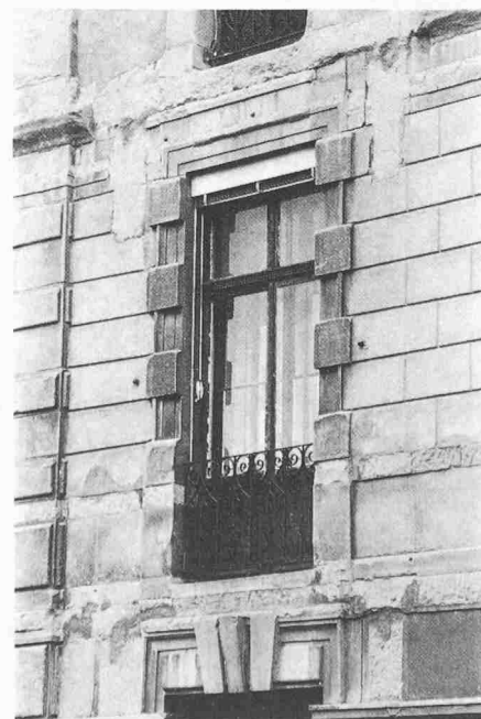
Schäden auf der Südwestseite
