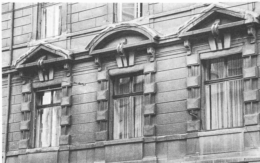
Verwitterungsschäden an den Dreieck- und Segmentgiebeln der Hauptfassade
