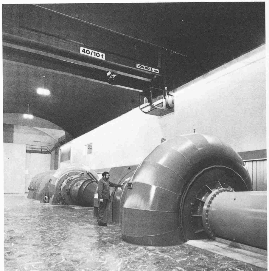
Fig. 7. Pont roulant 40/10 t (portée: 11,10 m): Vue partielle avec cabine de commande vitrée (le câble pour la commande au sol est visible, enroulé contre une paroi de la cabine)
