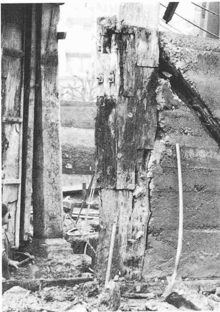
Wehrpfeiler 4/5 mit Flickarbeiten aus drei Jahrhunderten
