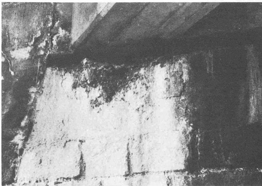
Bild 1. Schäden an der Infrastruktur. Beschädigung von Auflagerbänken, Verschmutzungen und Ausblühungen an den Mauern der Widerlager. Schäden infolge undichter Trennfugen.
