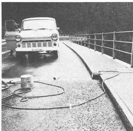
Bild 5. Widerlagerverschiebung. Die Schynstrasse durchquert zwischen Thusis und Davos mehrere instabile Hänge, so dass die Widerlager der Bauwerke in Zonen zu stehen kommen, die in Bewegung sind. Eine solche Widerlagerverschiebung wird durch die grosse Verschiebung – ca. 10 cm – zwischen den Randsteinen der Gehwege im Fugenübergang veranschaulicht.
