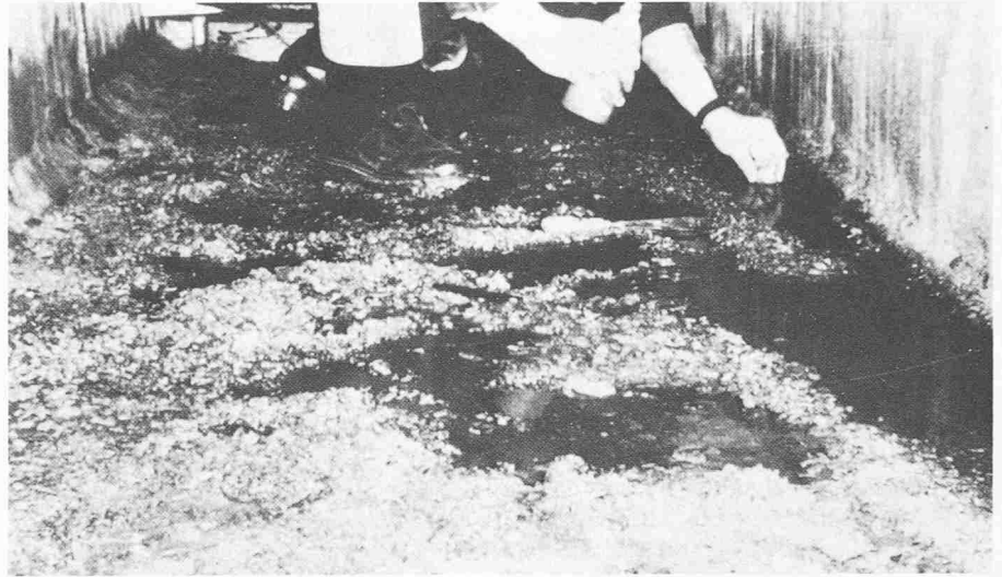
Bild 8. Frostschäden in Hohlkästen von Kastenträger. Frostschäden an unzugänglichen Hohlkastenboden. Die Schäden werden durch die Korrosionswirkung der Tausalze verursacht. Als Folge von Wasseraustritten aus Rohrleitungen hat sich das Wasser in den Hohlkästen angesammelt. Die Korrosion des Betons erreichte 7 cm Tiefe
