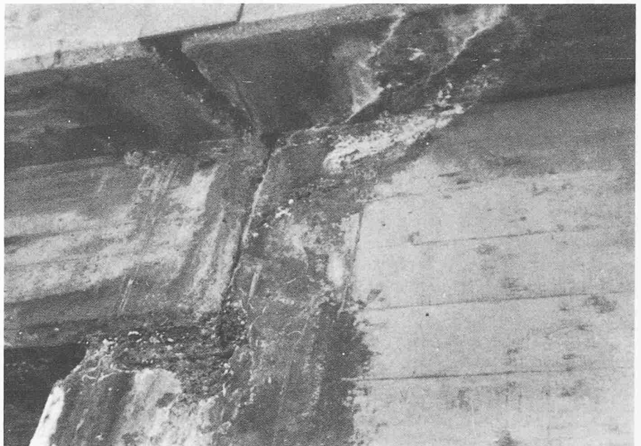
Bild 2. Beton-Tausalzschäden. Korrosionsbeispiel an Widerlagermauern eines Bauwerks infolge Frostwirkung und Einwirkung chemischer Auftaumittel Zu beachten, dass Wasser durch die Fugenübergänge eindringt, und dass die Auflager unzugänglich sind. Unterführung des Anschlusses Splügen, Höhe 1450 m, N 13c, Abschnitt Andeer-Splügen, Baujahr: 1965. Die Schäden sind 1970 behoben worden
