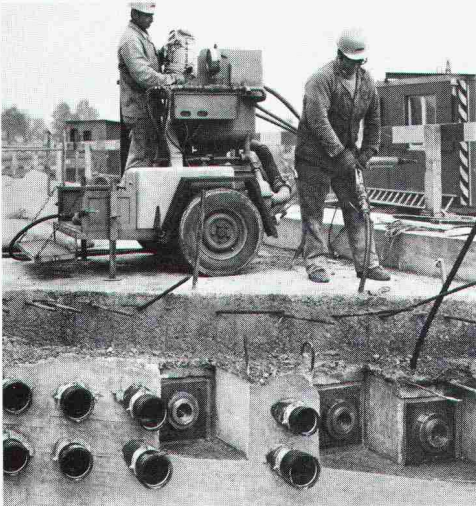
Gut ausgebildete, erfahrene Monteure injizieren die BBRV-Spannkabel sorgfältig und fristgerecht.
