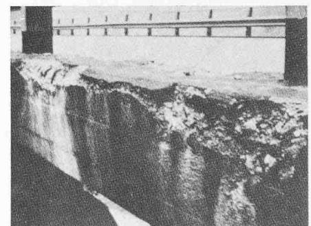
Bild 2. Tiefergehende Betonschäden an Kordonaussenseite. Armierungsseisen sind freigelegt
