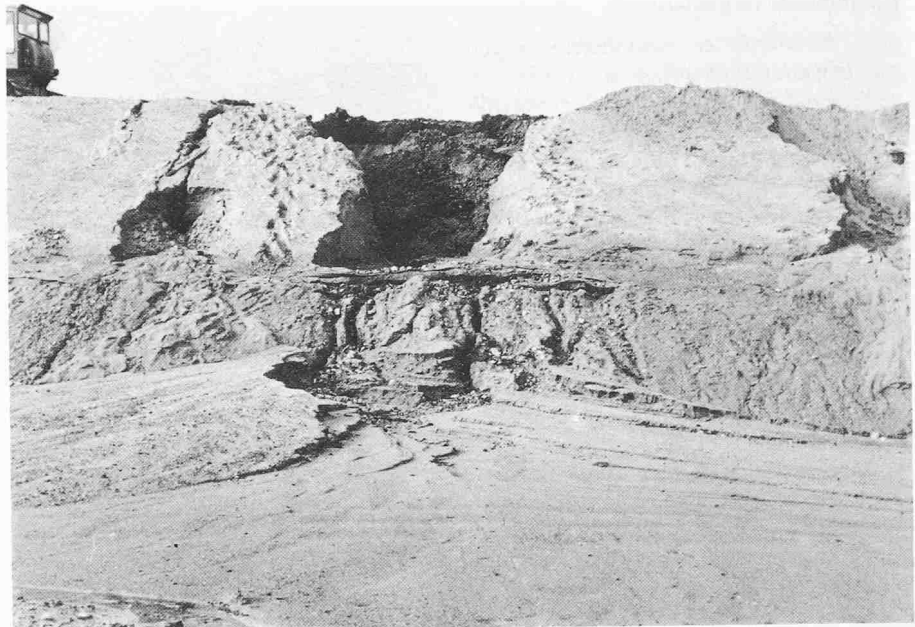
Bild 12. Kerzers N1. Starke Niederschläge verursachten tiefe Erosionsrinnen in den angeschnittenen Böschungen
