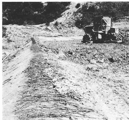
Bild 3. Salzweid N1. Auf ein rückwärts geneigtes Planum wurden Weiden und bewurzelte Pflanzen ausgelegt und darüber weitergeschüttet. (Stabilbauweise)
