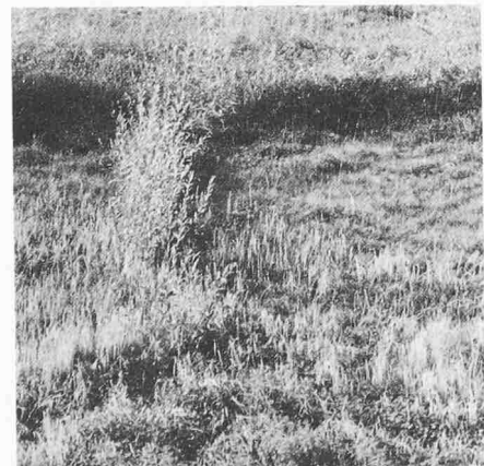
Bild 14. Kerzers N1. Drei Monate nach Einbau der Faschinen und Buschlagen verbrauchen die Weiden viel Wasser durch ihr Wachstum und verhindern damit Erosion. (biotechnische Entwässerung)
