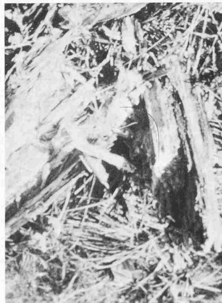
Bild 4. Moderfäuleangriff an einem Leitungsmast
