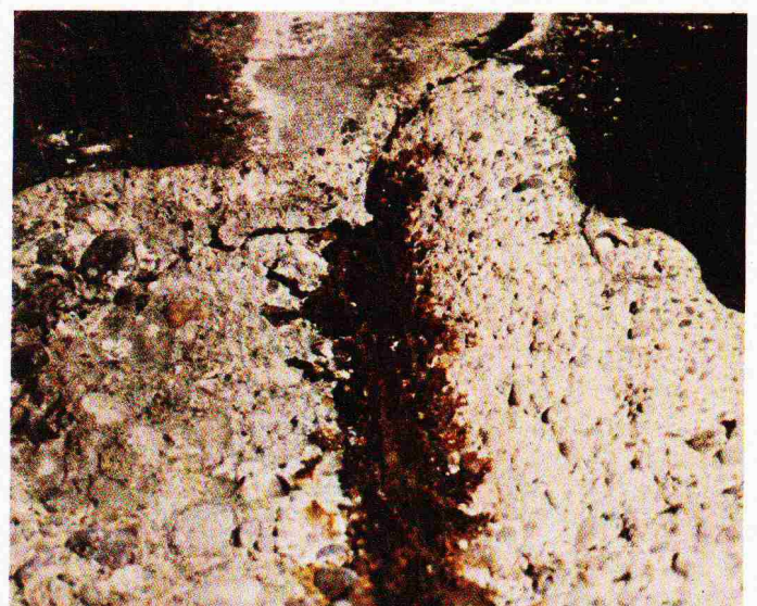
Brücke C. Die Stahleinlage von 30 mm Durchmesser besteht nur noch aus Eisenoxid!
