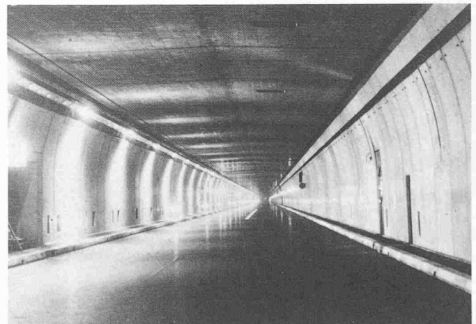
Bild 3. Notbeleuchtung mit eingeschalteter Brandnotbeleuchtung
