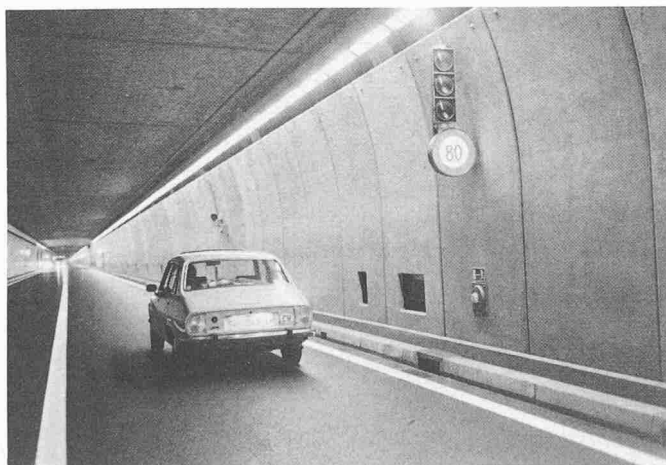
Bild 2. Beleuchtung der Mittelzone
