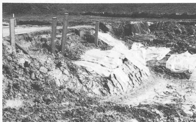
Bild 11. Baugrube Zürich, unmittelbar nach erfolgten Böschungsrutschungen. Man beachte das «Eintauchen» der Böschungsmasse in den Untergrund und die erhebliche rückwärtige Ausdehnung der Instabilität
