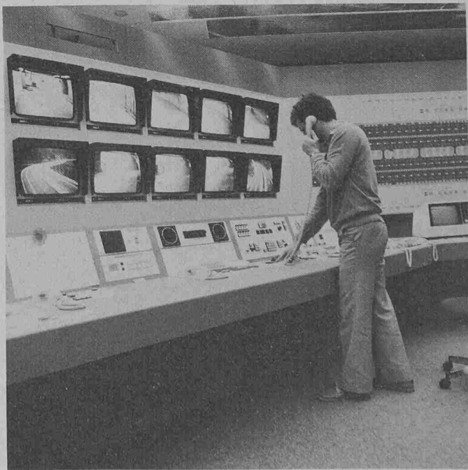
Bildinformationen aus Tunnel und Portalzonen für das Bedienungspersonal
