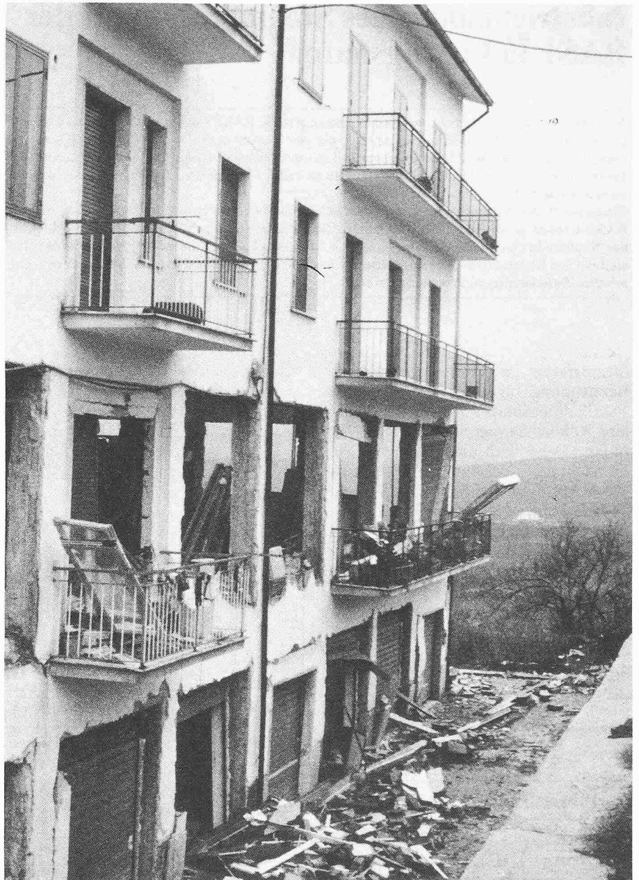
Bild 4. Stahlbetonskelettbau in S. Angelo dei Lombardi. Die Füll- und Zwischenwände in den untersten zwei Geschossen sind grösstenteils zerstört. Bedeutende Schäden an der Tragstruktur
