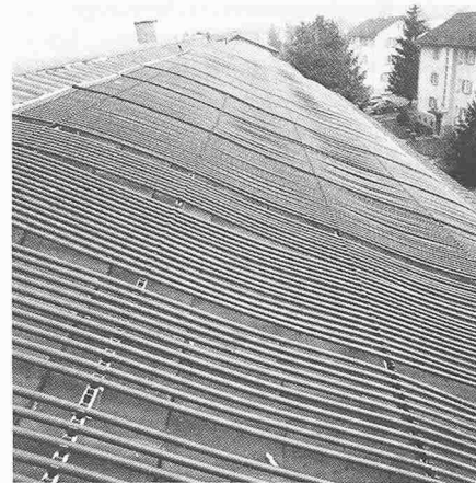
Niedertemperaturkollektoren (Kunststoffrohre, gefüllt mit Wasser) nutzen die ganze Oberfläche: Energiedach
