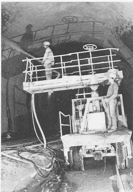
Bild 4. Gespritzt wurde von einem mobilen Gerüst aus mit einer Mischung, bestehend aus 425 kg Hochofenschlackenzement auf 1000 l Sand 0–8 mm. Die Verwendung von Hochofenschlackenzement (75% gemahlene Hochofenschlacke + 25% Portlandzement) war vorgeschrieben. Da verschiedentlich gegen Wasserandrang gekämpft werden musste, wurden je nach Erfordernis Schnellbinder zugegeben. Der «Guniteur» an der Spritzdüse steuerte den Nachschub an Spritzmörtel, Wasser und evtl. Schnellbinder von der Düse aus
