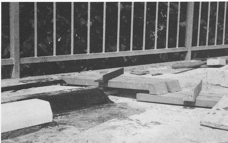
Bild 10. Überführung B-235 Tegerfelden. Nachträglicher Einbau von Stahlschwellen im Zuge der Dichtungs- und Belagssanierung 1976. Diese 44 m lange, schiefe, vorgespannte Platte mit eingespannter Mittelstütze war 1953 ohne Fahrbahnübergänge erstellt worden
