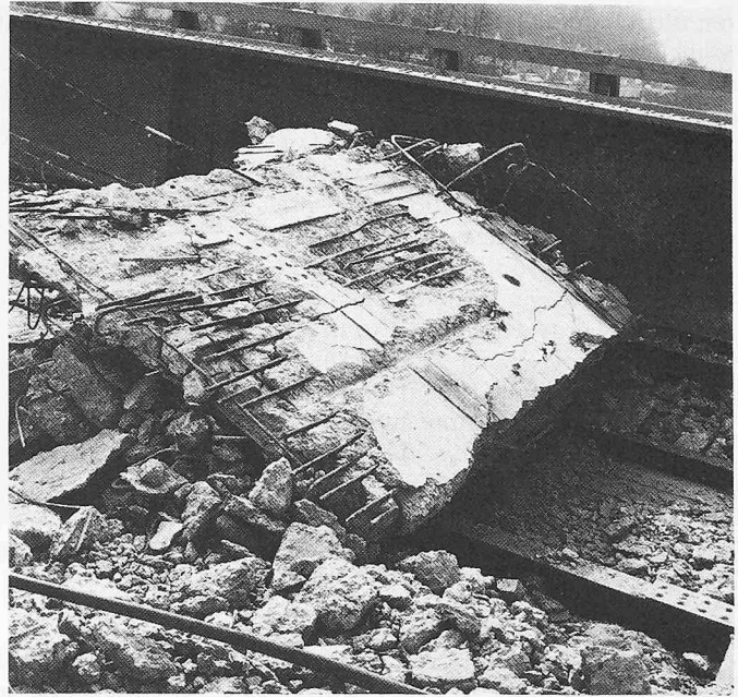
Bild 29. B-003. Die beim Abbruch umgestülpte Betonplatte mit den Betonabplatzungen
