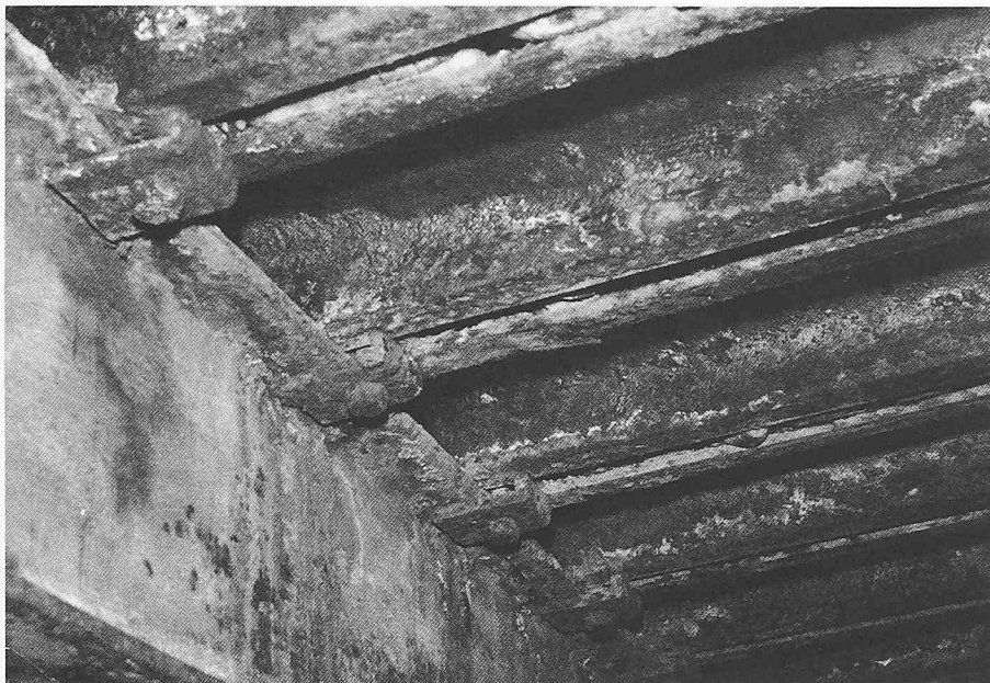
Bild 9. B-001, Verrostete Zoreisenfahrbahn. Untersicht, mit Längsträger (links)
