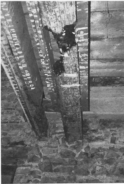
Zerstörter «tragender» Deckenbalken im Haus Pfeffergässlein 8
