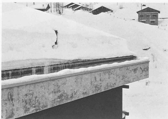
Bild 7. Traufbereich im Winter. Eisschicht sowohl über der Dacheindeckung wie auch zwischen Eindeckung und Unterdach
