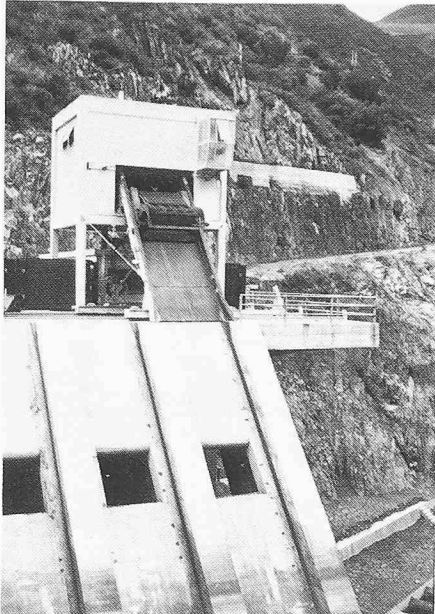
Bild 32. Rechenreinigungsmaschine, von vorne gesehen
