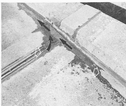
Bild 4. Fahrbahnübergang mit aufsteigendem Wasser aus dem Fahrbelag und Anschlüssen. Der Anschluss zum Fahrbahnübergang wurde bereits mit GA saniert
