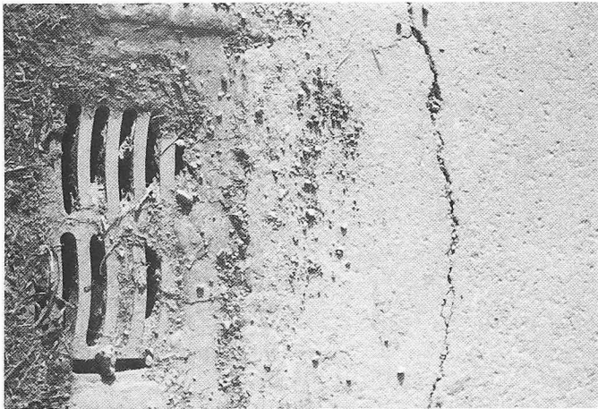
Bild E1. Sichtbar: gerissener Walzasphalt
