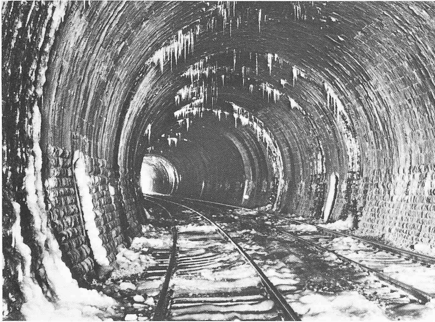
Bild 1. Älterer Eisenbahntunnel vor der Instandsetzung
