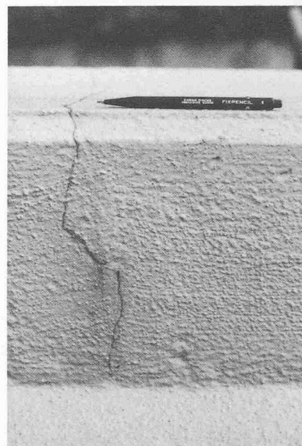
Bild 7. Rissbildung in gut haftender Beschichtung mit der Gefahr erneuter Schadenbildung
