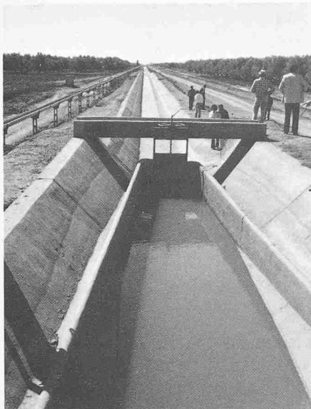
Bild 2. Prismatischer Bewässerungskanal mit einem «Entenschnabel»-Überfall. Solche Überfälle repräsentieren auf einfache Weise das Prinzip der Regulierung des Kanals nach dem Oberwasserspiegel
