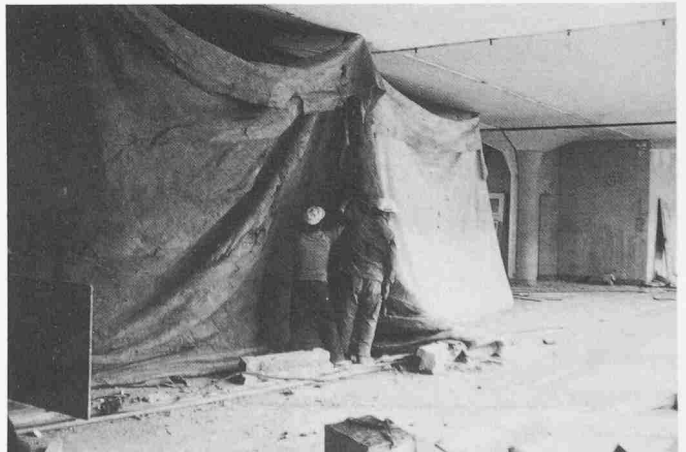
Bild 4. Liftschacht im nördlichen Flügel. Vor der Sprengung: Anbringen der dreifachen Vorhänge aus schwerer Vliesmatte
