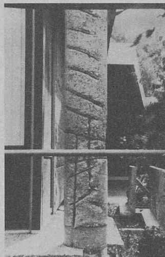
Bild 1. Ernsthafte Betonschäden am Verwaltungsgebäude eines Industrie-konzerns. Schon vor vier Jahren war erfolglos versucht worden, die Stahlbeton-Rundsäulen zu retten
