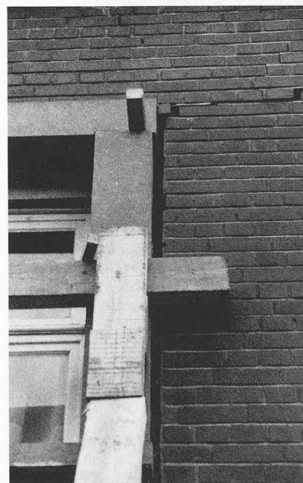
Bild 8. Die massive, seitliche Fenstereinfassung ist um mehrere cm verschoben. Dies deutet auf eine kurzzeitige Entlastung in vertikaler Richtung hin
