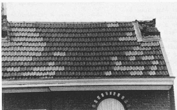
Bild 9. Dach mit zerstörten Kaminen. Die hellen Partien zeigen das Ausmass der zerstörten Dachziegel. Beide Kamine sind in die gleiche Richtung gefallen (E-W)
