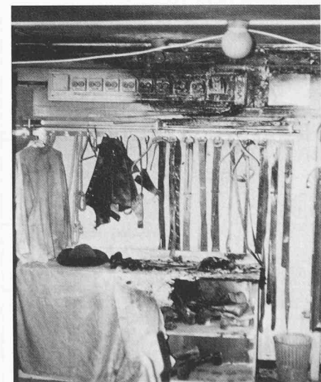
Ein praktisches Beispiel der Brandentdeckung in einem Theater: In der Garderobe entzündeten sich Kostüme, und die Flammen griffen bereits gegen den Sicherungskasten. Dank automatischer Entdeckung konnte das Feuer sofort gelöscht werden (Foto Cerberus)
