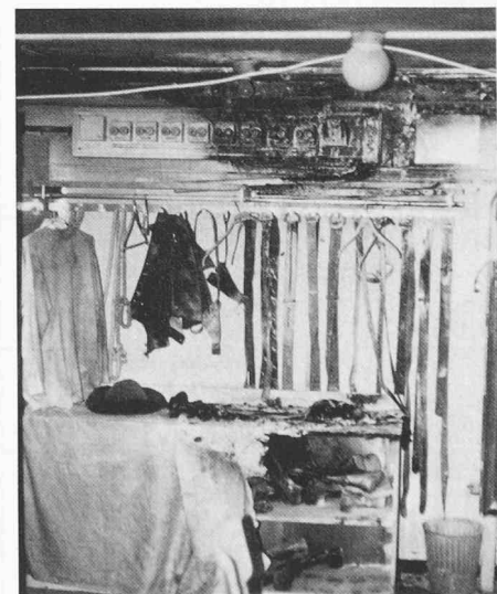
Ein praktisches Beispiel der Brandentdeckung in einem Theater: In der Garderobe entzündeten sich Kostüme, und die Flammen griffen bereits gegen den Sicherungskasten. Dank automatischer Entdeckung konnte das Feuer sofort gelöscht werden (Foto Cerberus)
