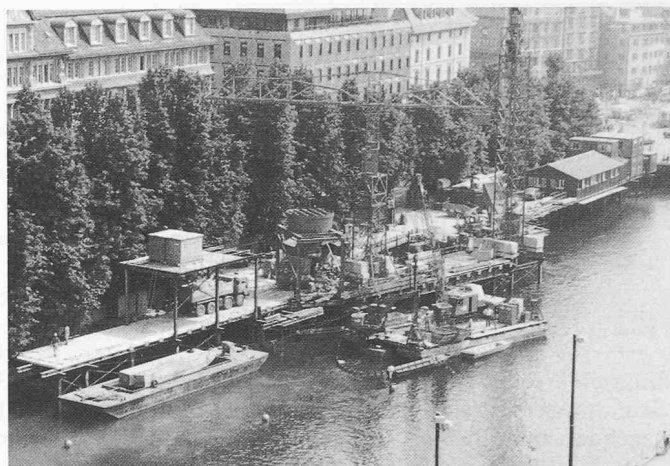
Bild 6. Installationsplattform und Angriffsschacht Limmat. Auf dem Ponton in Bildmitte sind die Geräte für die Rütteldruckverdichtung installiert
