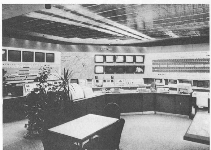
Bild 3. Kopfstation Stans verkehrstechnischer Teil
