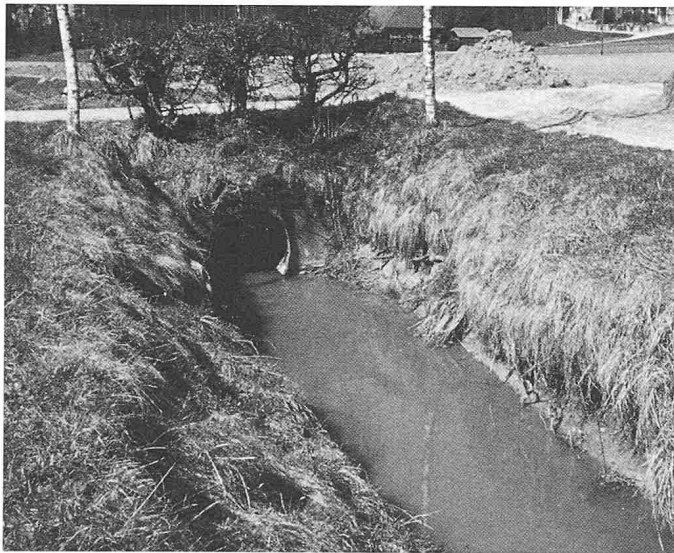
Bild 1. Schwarzbach: unterspülte Grasnarben vor der Verbauung
