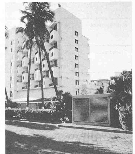
Bild 9. Schäden am «Aristos»-Hotel in Ixtapa. Analoge Schäden waren bereits beim Erdbeben 1979 aufgetreten (vgl. [3])
