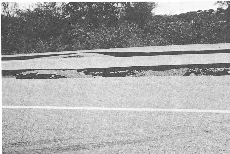
Bild 12. Risse im Strassenkörper im Anschluss an die Brücke über den Rio Balsas (vgl. Bild 11)
