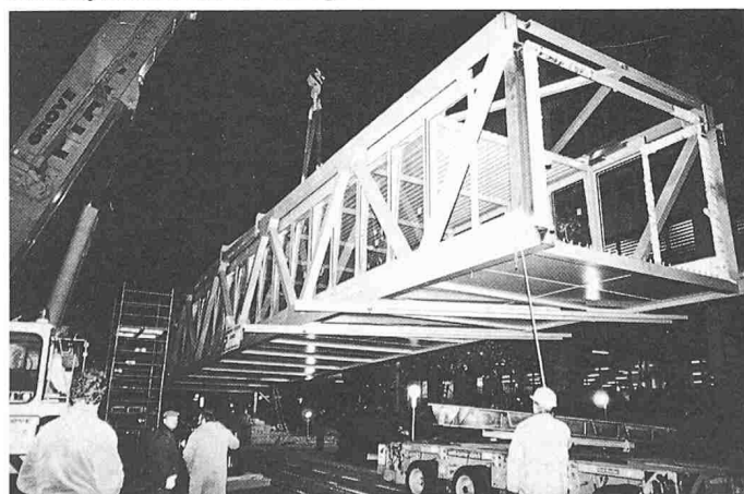
Das Hauptelement wird vom Kran gehoben – was nur bei demontierten Fahrleitungen geht
