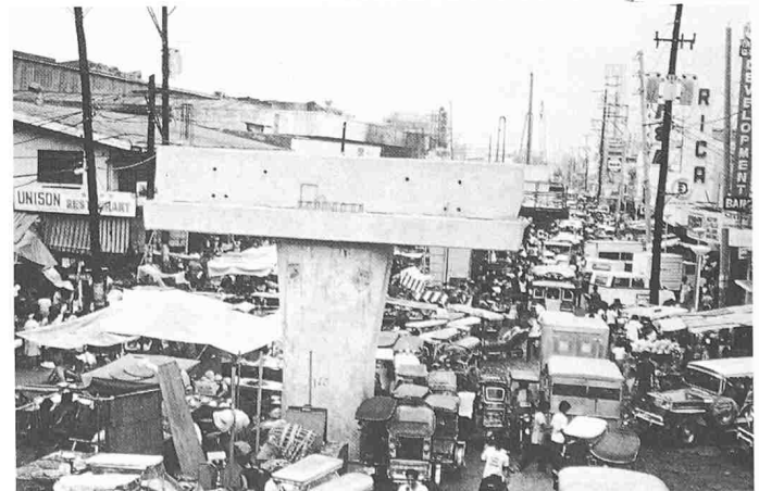
Bild 6. Aus dem Fundament wachsen die Pfeiler mit den Querträgern, Lichtraumprofil 4,5 m Höhe
