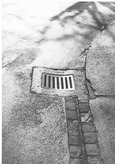
Bild 5. Längsgerillte Dolendeckel sind gefährlich, sie sollten unbedingt ersetzt werden
