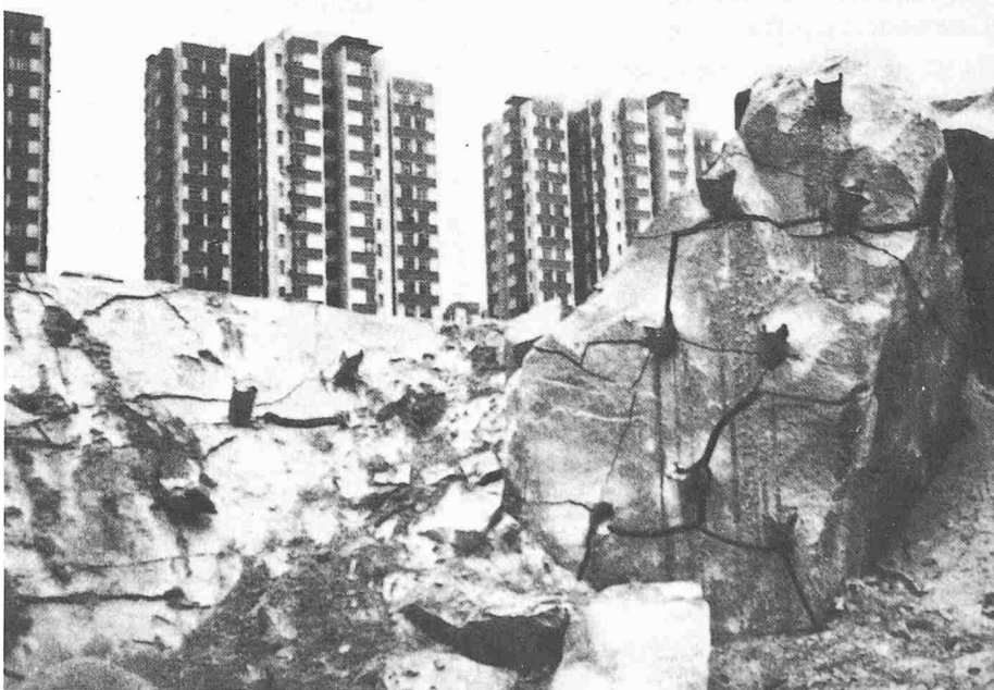
Bild 1. Zerstörungseffekt bei Verwendung von Expansionsmörtel nach 2 Tagen Einwirkungszeit, etwa 20 m 3 anstehender Fels
