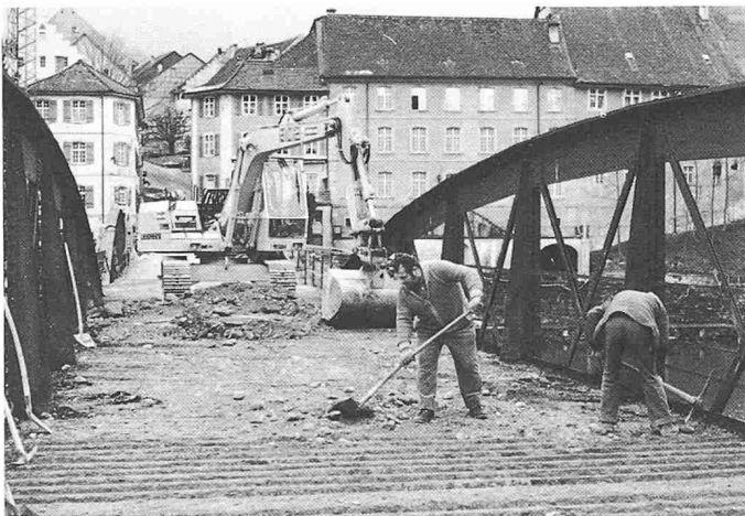
Bild 3. Entfernen von Chaussierung und Belag der Zoreisenfahrbahn 1984. Im Hintergrund die Altstadt von Kaiserstuhl mit dem Engpass beim Zoll
