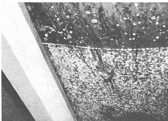
Bild 2. Pilzbildung am Unterdach
