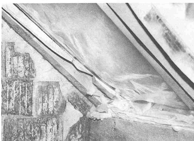
Bild 3. Nicht luftdichte Anschlüsse bei Sparren und Schwelle
