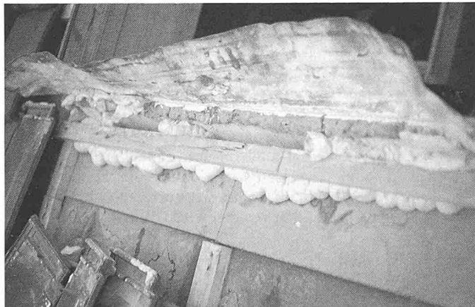
Bild 3. Falsch: PU-Schaum ist keine ausreichende Luftdichtung, aber auch seitlich ist kein Abführen des Kondenswassers möglich
