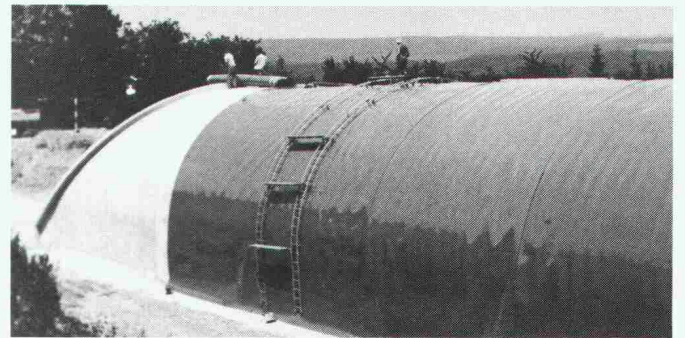
Tunnel «Nordumfahrung Zurzach» – zur Zeit in Ausführung: abgedichtet mit 30 000 m 2 Sarnafil Typ FP 4 mm.
